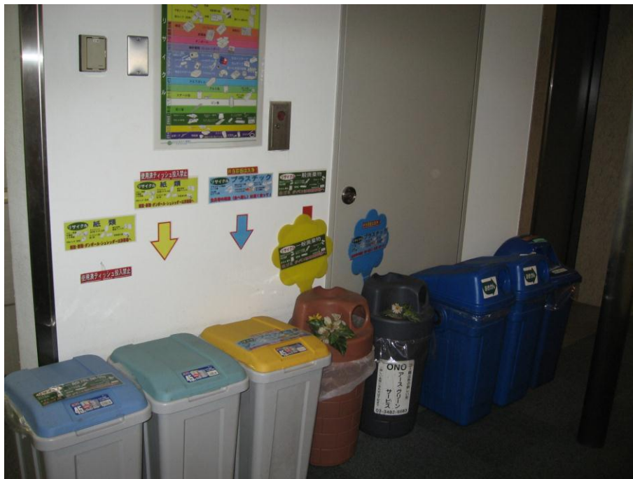
(写真)伊藤園本社ビル地下1階廃棄物分別BOX
